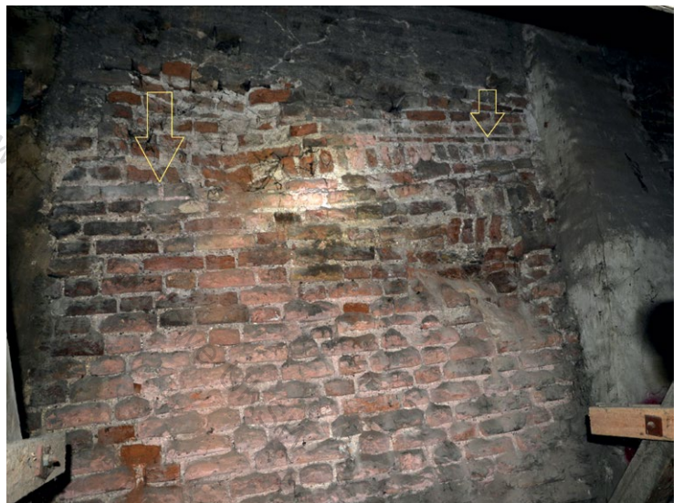
19. Różnica muru na poddaszu budynku.
