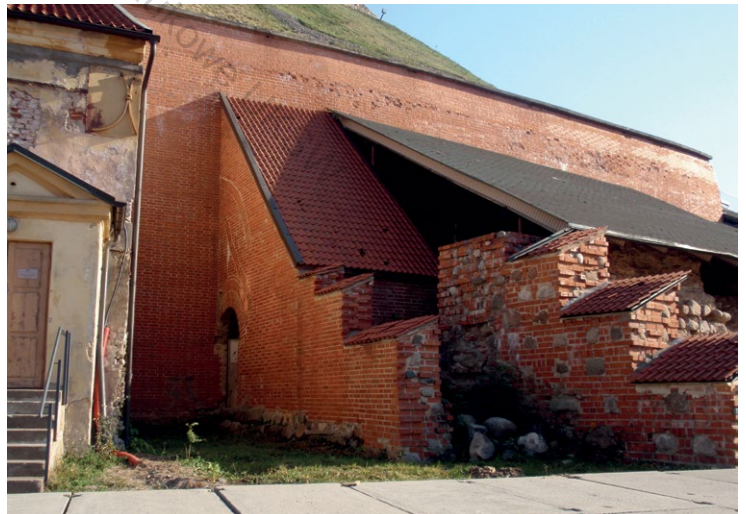
10a. Początek częściowo rekonstruowanej galerii przy ścianie oporowej, wzniesionej przez Jana Hozjusza za pałacem Radziwiłłów i służącej za łącznik z Pałacem Wielkoksiążęcym. Na styku z Domem Horodniczego pod kątem prostym odchodziła dwukondygnacyjna galeria – łącznik z Domus nova – pałacem Zygmunta Augusta (ob. Nowy Arsenał). Fot. B.R. Vitkauskienė, 2018 r.
